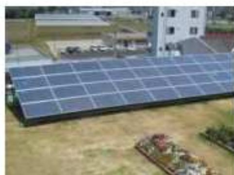
本社屋上 10kW
