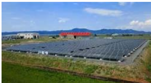
2013年07月 (株)サンパワー昭和発電所 (熊本県八代市)
