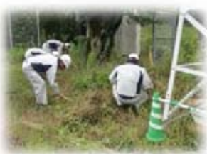
6月5日 池田変電所 発変電部2名、協力会社3名 (橋塚代理人)
