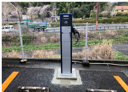
お客様の敷地に設置したEV充電器
