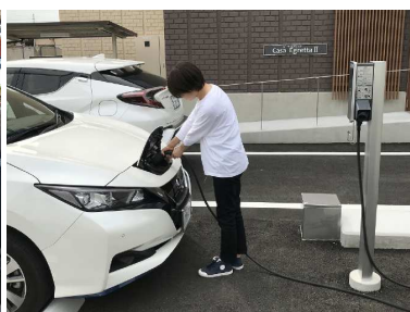
寮に設置しているEV充電器
