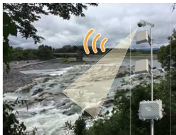
災害時 河川監視中継
