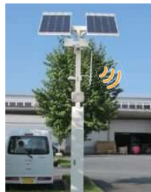
観光・防災 Wi-Fi ステーション
