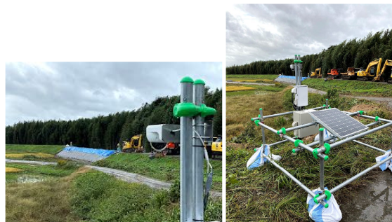
災害現場に設置された様子
