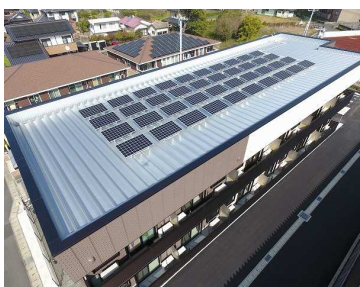
屋上の太陽光発電パネル
