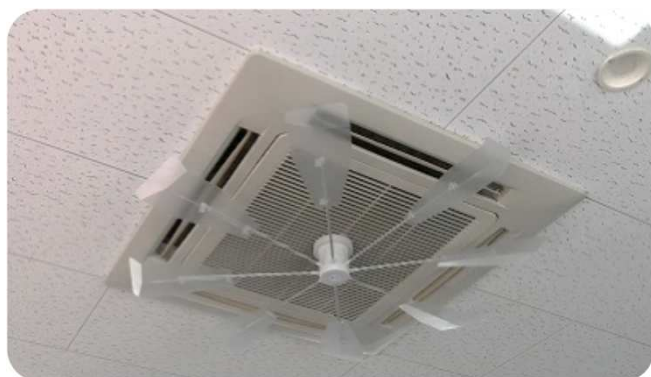
執務室に取付けたハイブリッドファン
